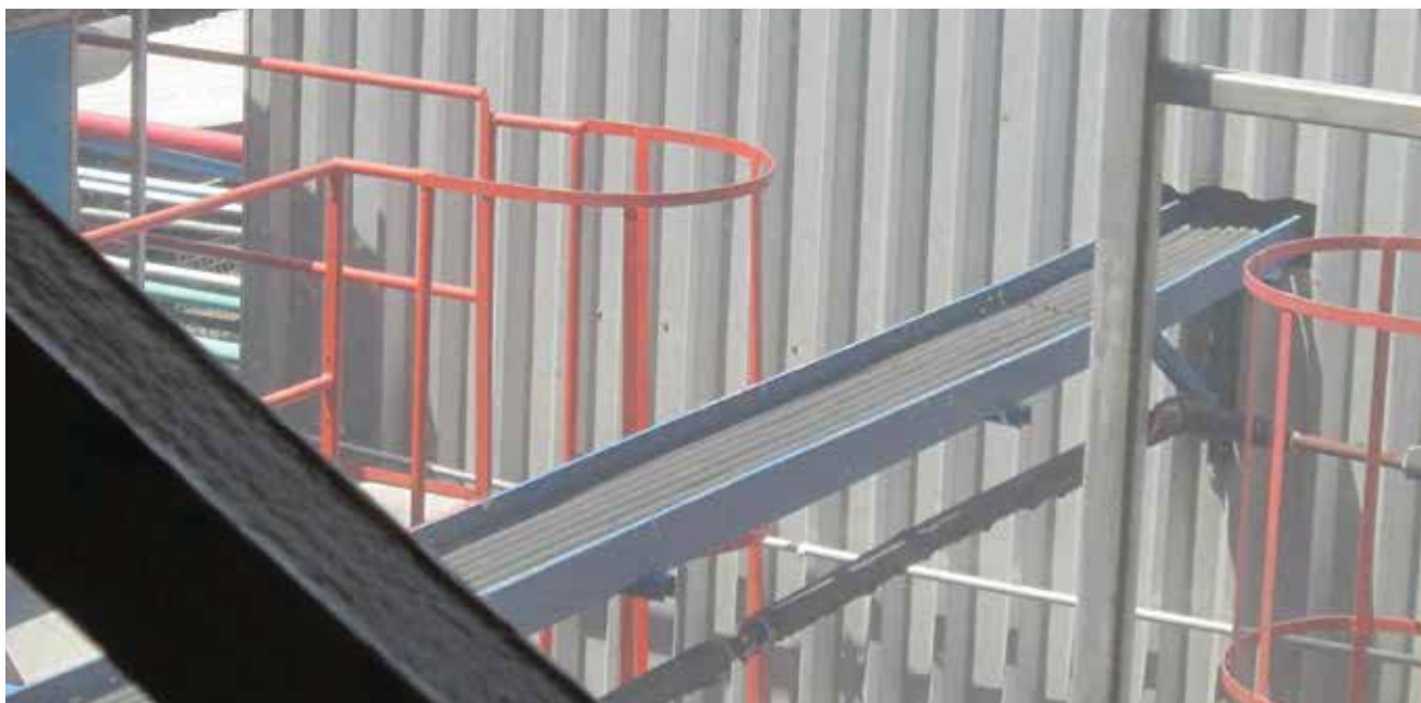
SUPERFLEX instalado en bandejas.
